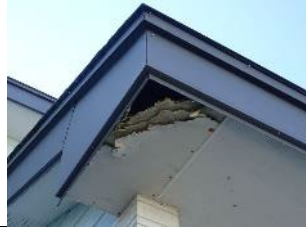
軒裏 破損 (3号棟)
