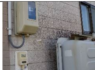
外壁 汚れ (5号棟)
