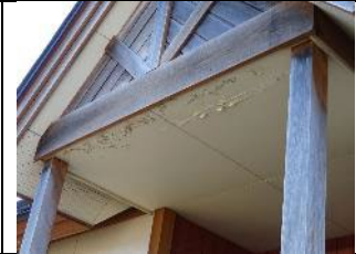
軒裏 塗装剥離 (4号棟)
