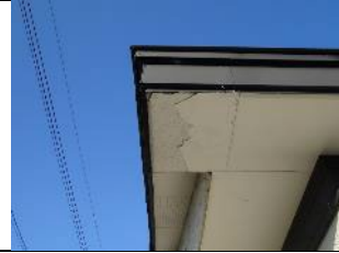
軒裏 破損 (7号棟)
