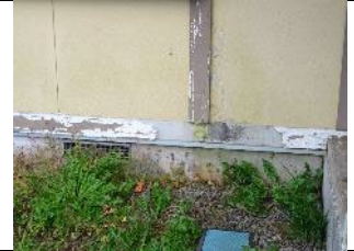
木材 破損、塗装剥離 (8号棟)
