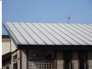
屋根 チョーキング(1号棟)
