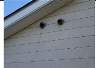
外壁 汚れ (4号棟)
