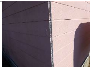
外壁 目地欠損 (1-2号棟)
