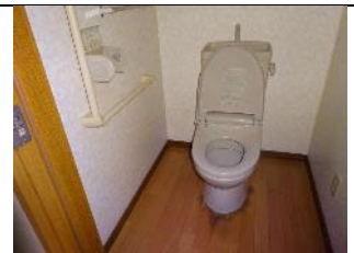
トイレ 手すりあり、床の傷み
