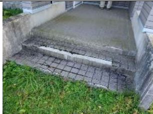
階段タイル 破損 (2号棟)
