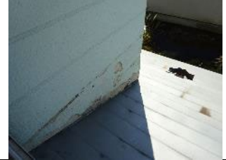
外壁 塗装剥離、破損 (3号棟)
