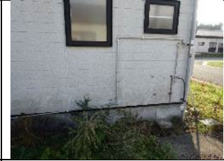
外壁 汚れ (7号棟)
