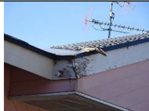
屋根 破損 (3-4号棟)
