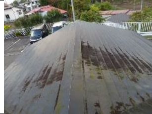
入口屋根 汚れ (8号棟)
