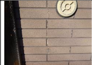
外壁 ひび割れ (2号棟)
