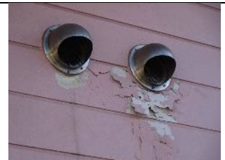
外壁 塗装剥離
