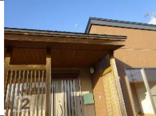
庇 木材の劣化 (1号棟)
