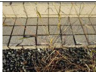
階段タイル 破損 (1号棟)
