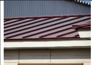
屋根 チョーキング(5号棟)
