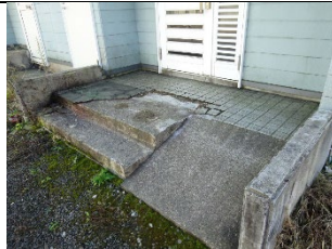
階段タイル 破損 (4号棟)
