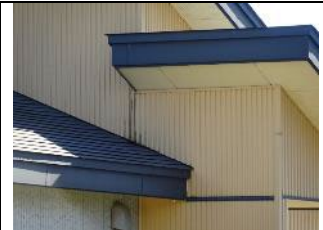
外壁 汚れ (1号棟)
