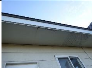
軒裏 破損 (2号棟)
