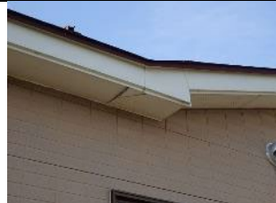
軒裏 破損 (5号棟)
