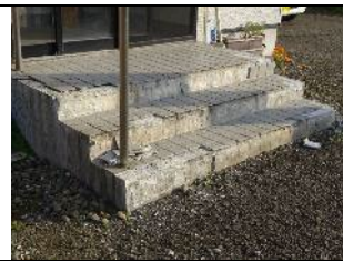
階段タイル 破損 (6号棟)
