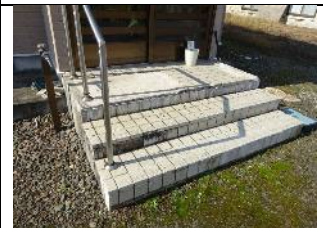
階段タイル 広範囲破損 (7号棟)
