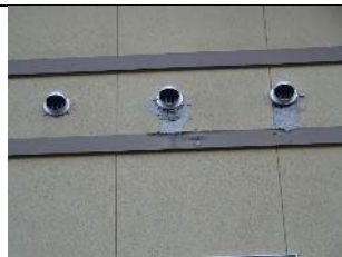
外壁 換気口下の腐食 (5号棟)
