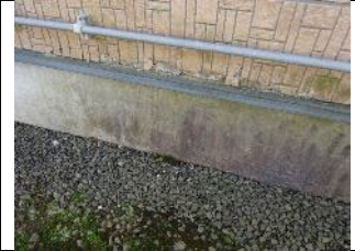
外壁 塗装剥離・汚れ (9号棟ほか)
