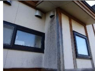
外壁 汚れ (4号棟)
