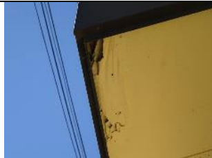
軒裏 破損 (2号棟)
