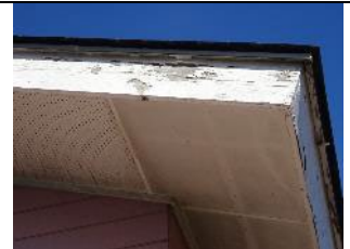
破風 塗装剥離 (1-2号棟)
