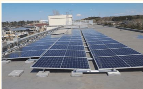
太陽光パネル
