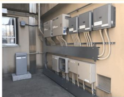
蓄電池・パワーコンディショナー等
