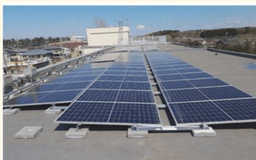
太陽光パネル
