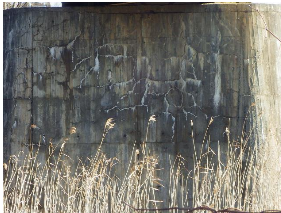
写真-3 橋脚の劣化状況
