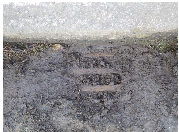
写真-6 排水柵の土砂詰り
