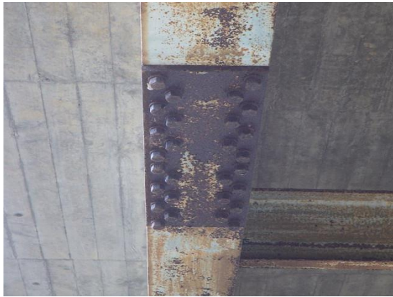
写真-1 主桁の劣化状況
