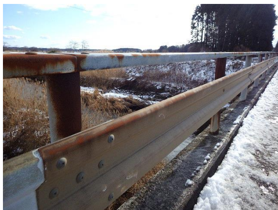
写真-5 防護柵の損傷
