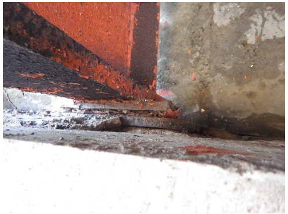
写真-4 支承の劣化状況
