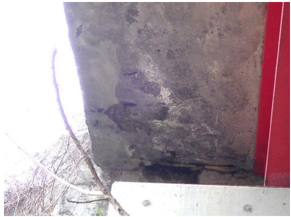
写真-2 床版のはく離・鉄筋露出
