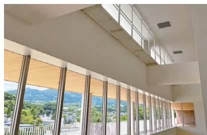
自然採光窓(南部町庁舎)
