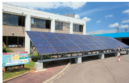
太陽光発電設備(七戸町本庁舎)
