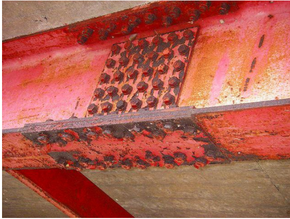
写真-1 主桁、横桁の劣化状況
