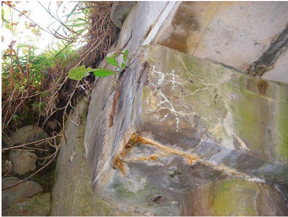
写真-3 橋台の劣化状況
