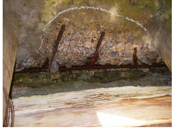
写真-2 床版のはく離・鉄筋露出
