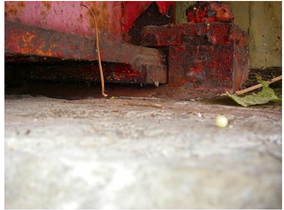
写真-4 支承の劣化状況
