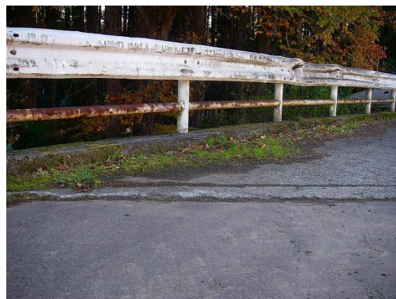
写真-5 防護柵の損傷
