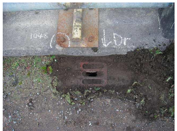
写真-6 排水柵の土砂詰り
