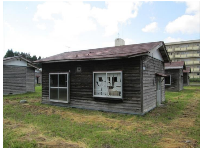
住棟劣化状況
